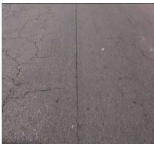
Figura 11: Fessura longitudinale da giunto di stesa.
