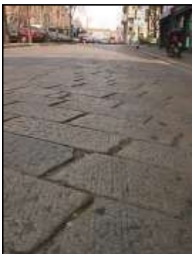
Figura 12: Eccessiva apertura dei giunti non sigillati
