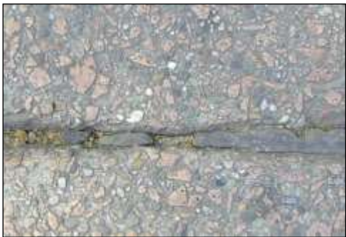
Figura 5: Degrado dei giunti precedentemente sigillati
