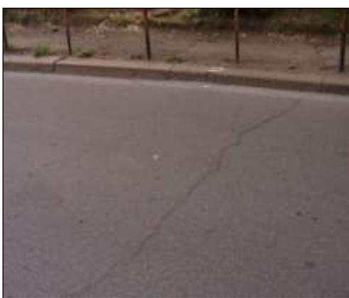
Figura 10: Esempio di fessura trasversale
